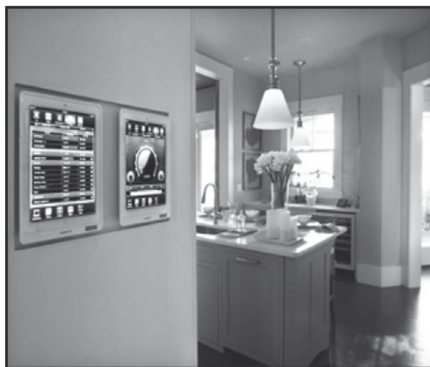
Abb. 6: Smart Home: Steuerungseinheit im Flur Quelle: businesswire.com
